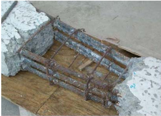
a) Material dañado removido
